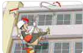
달비계를 사용하여 건물 외벽 청소에 구명줄 미설치
